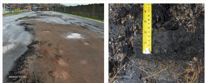
Fotos 09 e 10 – Estacionamento na Praça 9 de Julho: Pavimentação asfáltica deteriorada (situação em abril/2017)
