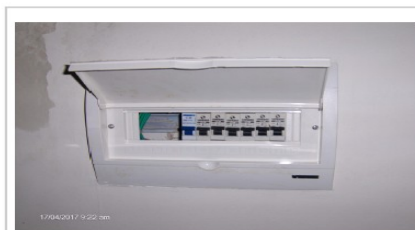
Foto 15 - Quadro de distribuição em resina termoplástica, para até 12 circuitos monopolares.
