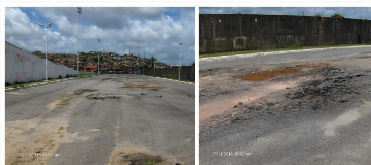
Fotos 03 e 04 – Estacionamento na Praça 9 de Julho: Pavimentação asfáltica deteriorada (situação em novembro/2016)
