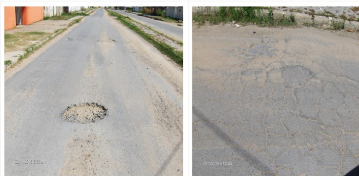
Fotos 01 e 02 – Avenida 05, em Enseada dos Corais: Pavimentação asfáltica deteriorada (situação em novembro/2016)
