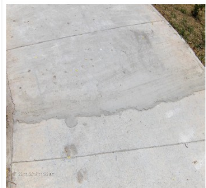
Foto 08 – Passeio na Praça Antônio Oliveira: Má execução
